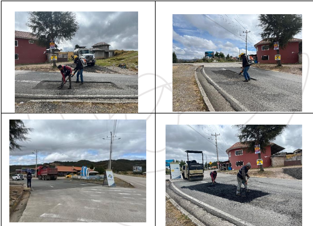
*Adaptado de Informe de labores del Año 2023 correspondiente a la Jefatura de Gestión de Peajes de Asfaltar EP
